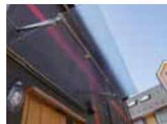
02 玄関屋根 A ランク
