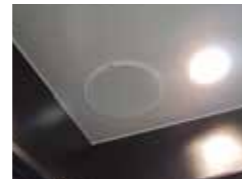
09 照明器具 A ランク
