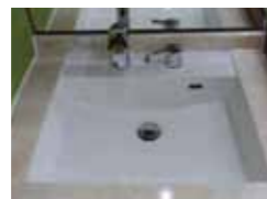
02 水栓 A ランク
