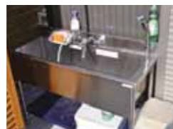
12 外部給水設備 A ランク
